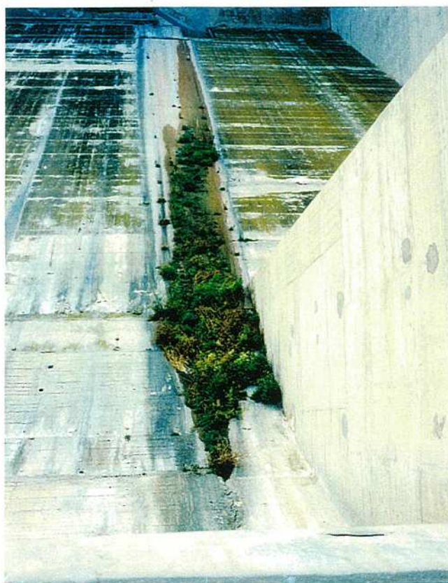
写真 2-2-16 天端からダム前面を見下ろす。 クラックに沿って生える草とわずかな漏水が見られる。
