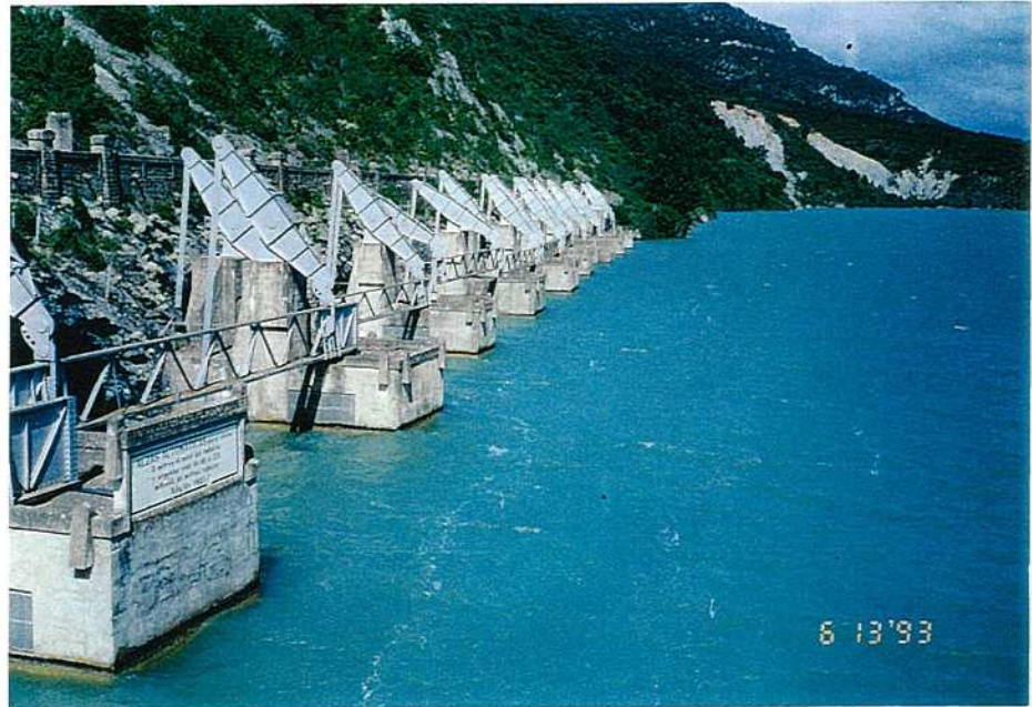
写真 2-2-17 右岸上流のトンネル洪水吐呑み口ゲート。
