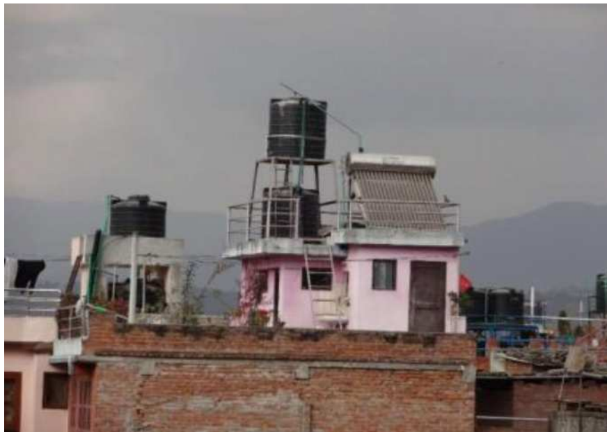
写真－4.8 屋上に設置された給水タンク
