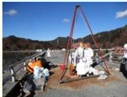
震災で損傷した堤体の現状把握(大柿ダム・浪江町)
