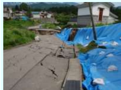
七五三掛集落の地すべり被害(鶴岡市)
