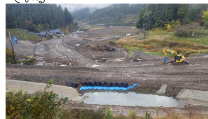
9月豪雨で越流して下流で土砂を含む洪水流となった（2024年11月24日撮影）
