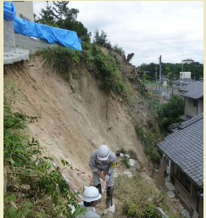
図13-1(右) 都市域で発生したかけ崩れの例
