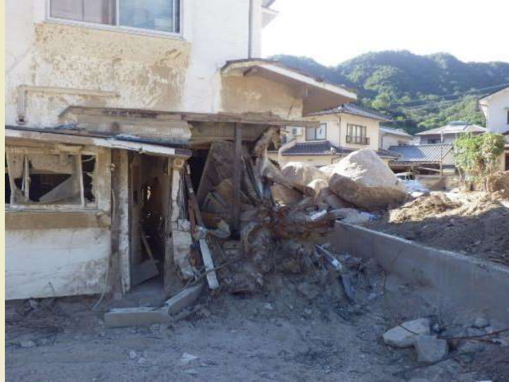
写真19-1 2018年7月西日本豪雨災害時の土石流被害
