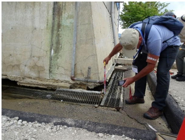
道の駅周辺の地盤沈下
