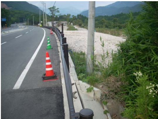
c) 道路のずれと亀裂
