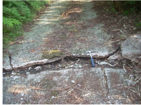
d) 南側 450m 離れた道路の段差（10cm）
