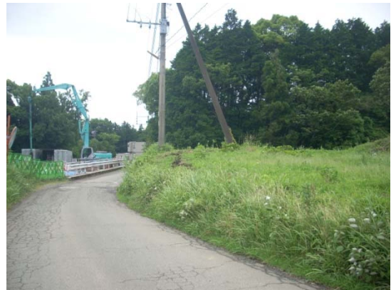
e) 中央の電柱付近の法肩の亀裂
