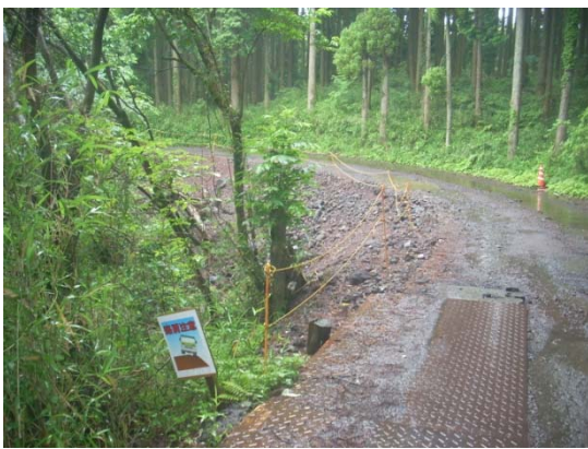
c) 西側 200m 離れた道路の路肩部の小崩壊
