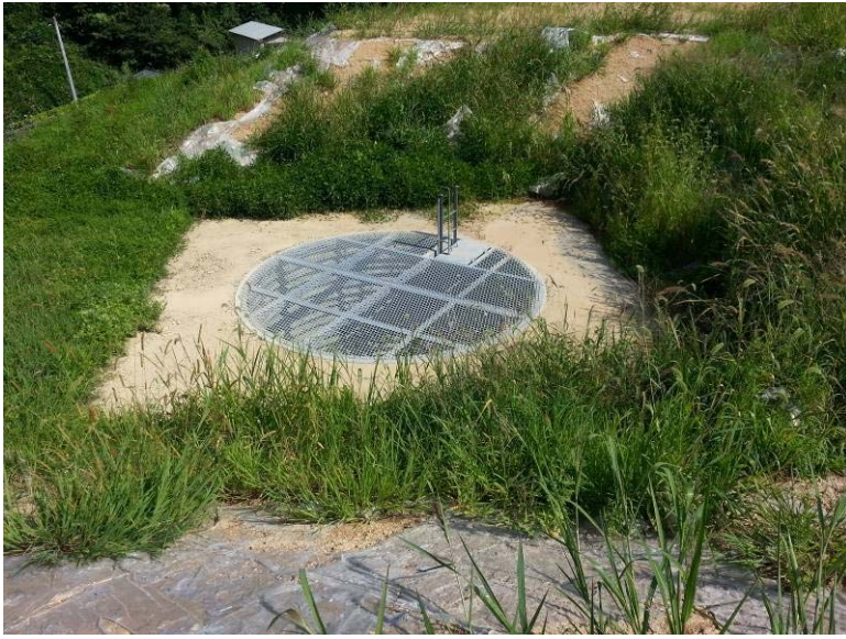
写真 3-1-3-1 埋立地内に設けられた集水井工の事例
