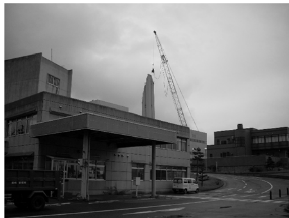
写真-1 中越沖地震における中間処理施設の破損事例 (2007年9月8日撮影)
