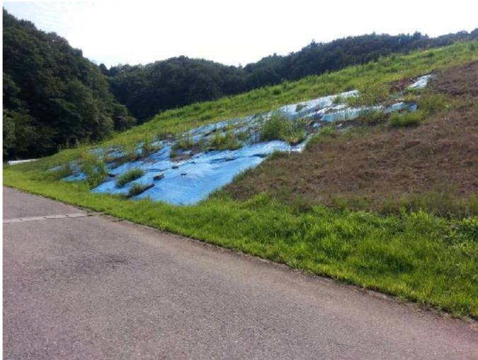
(b) B 処分場の例：ブルーシート部の崩壊
