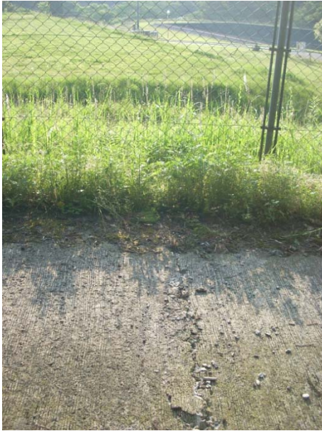
a) 東側の隣接道路の亀裂：奥の処分場埋立 地内に変位は見られない
