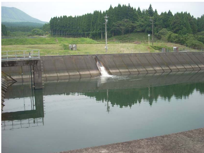
写真 3-1-1-3 2016 年熊本地震後の導水管等からの保有水等の放流状況
