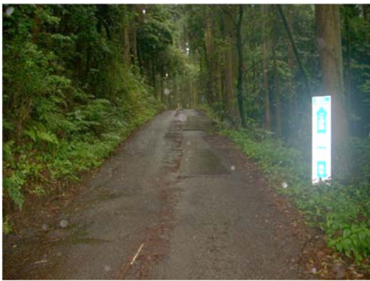
b) 西側 100m 離れた道路の段差
