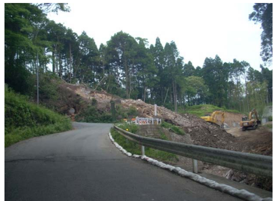
f) 法肩の斜面崩壊
