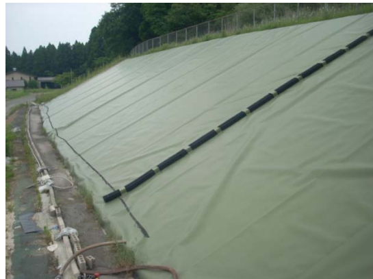
f)シートに変状なし
