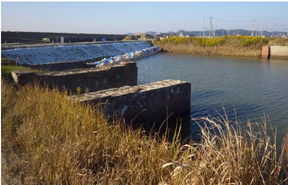
写真7：被災したレンガ橋台
