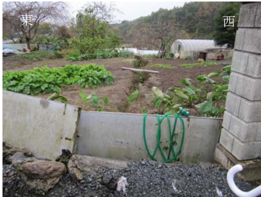
写真-5 変位発生後、7ヶ月を経ても断裂が残存している（2011,11,11撮影）。
