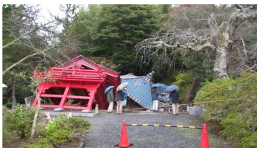
写真-2 断層変位により倒壊した建徳寺施設
