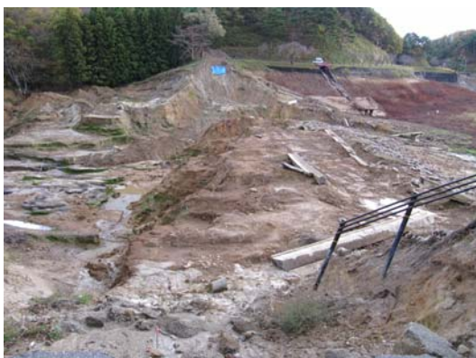
写真-9 決壊した本堤(左岸から臨む)
