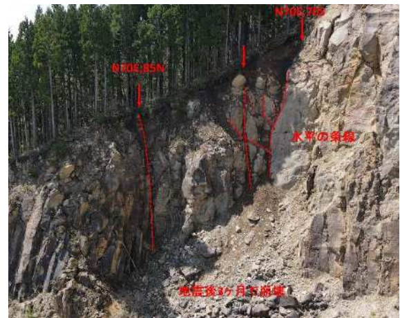
写真.1 地すべり西側斜面の断層露頭
