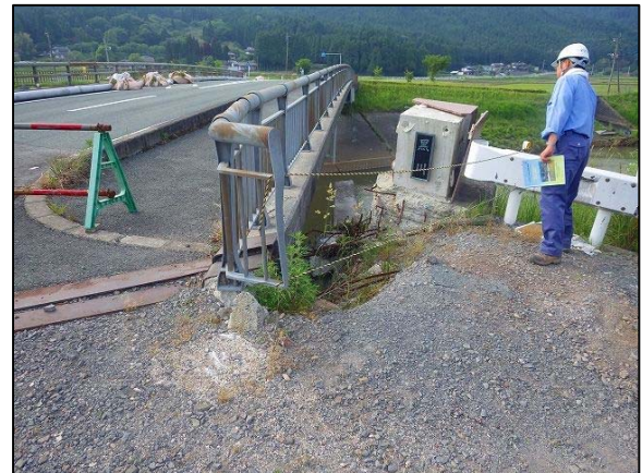
写真-5 黒川大正橋に発生した変状
