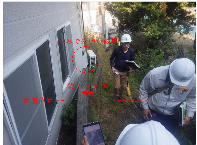
写真-1 御船町高木地区の地表地震断層 (住宅を横断し、壁・ブロック塀が変形)
