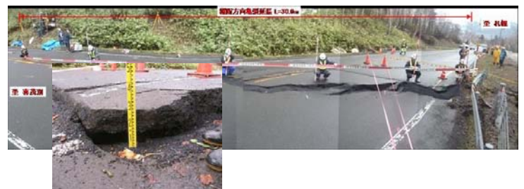
写真-1 路面亀裂の状況
