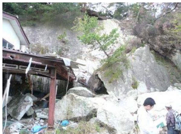
写真5 松島層上部軽石凝灰岩部層の岩石崩落
