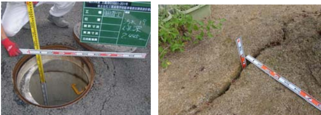
写真-3 構造物の変状 写真-4 亀裂発生状況
