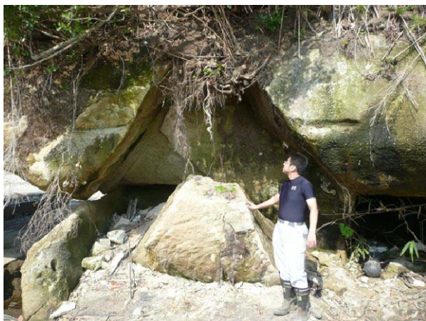
写真3 松島層上部軽石凝灰岩部層の岩石崩落
