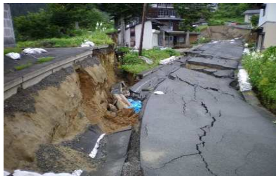
現地の被災状況
