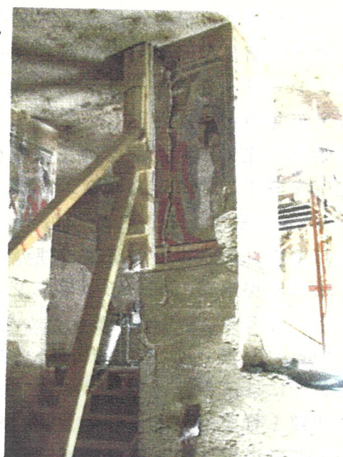
写真3 J室NO.3柱の破損状況
