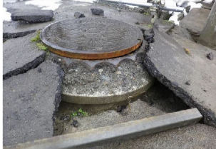
液状化による浮き上がり
