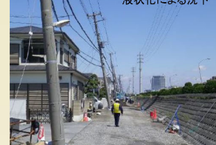
液状化による沈下
