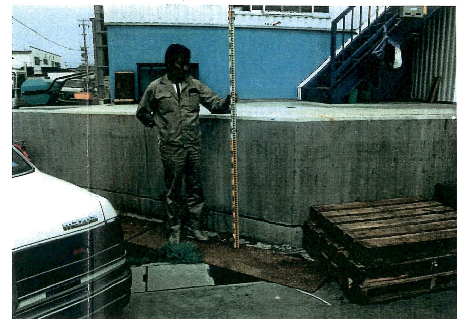
築後1年足らずで約3cmの亀裂が生じている。現在も沈下が進行していることが容易に伺える。
