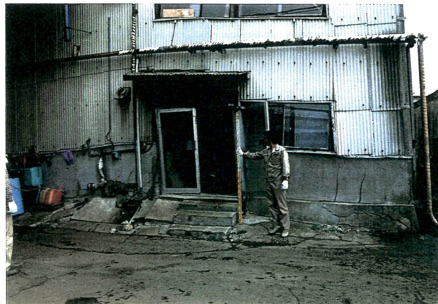
基礎杭打設位置は沈下せず（固定）、周辺が沈下したため杭頭が上屋を突き破っている。
