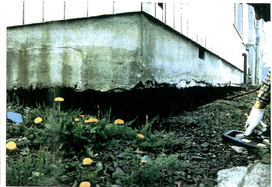
入江の中央部では、このように杭体が露出している構造物が多い。
