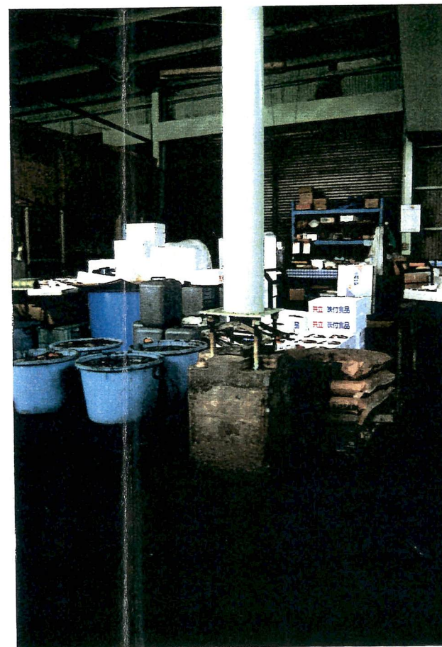
支柱部分が沈下し屋根がゆがむため、毎年コンクリートでかさ上げしている。その間はジャッキにより対処している。
