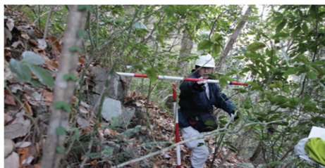
写真 5-3 エリア 1, 9 番 落石発生源
