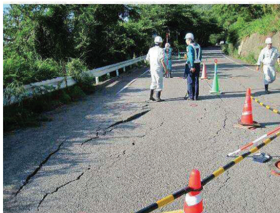
写真-1 路面に段差を伴う亀裂
