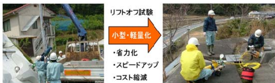
写真3-1 リフトオフ試験状況の比較 2)
