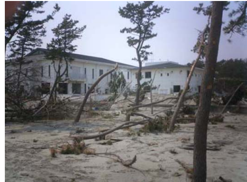
写真-2 被災後の浄化センター
