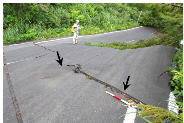
写真-3 アスファルトの乗り上げ
