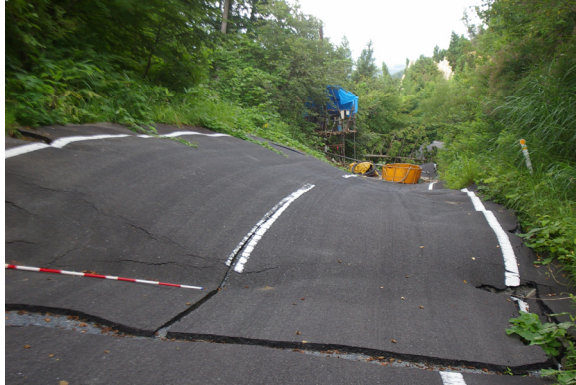
写真-4 アスファルトの膨らみ
