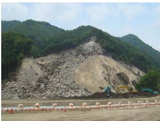
山腹の崩壊と復旧作業状況
