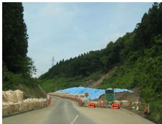
道路脇斜面の崩壊と応急対策状況
