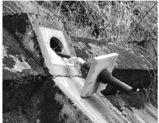
写真-1 アンカー変状例(引き抜き)
