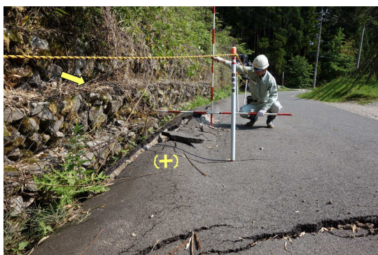
林道の隆起とフトンカゴの傾倒
