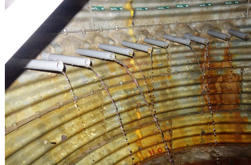
集水ボーリングからの排水状況
