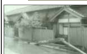
ガス導管の座屈(1964年新潟地震)
