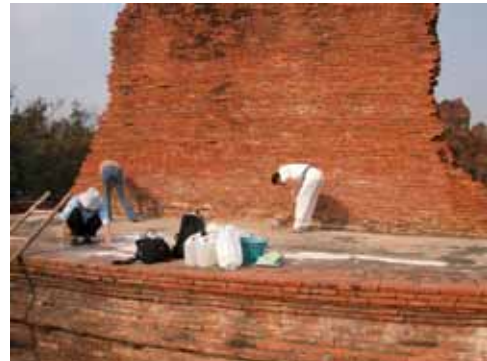
劣化原因への対処による保存対策
