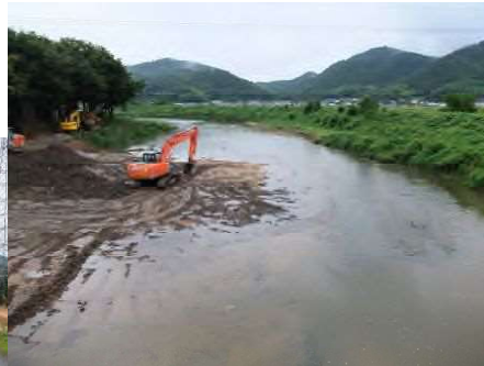
破堤箇所の上流側
