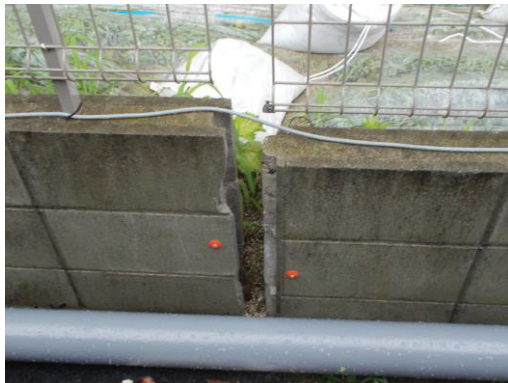
写真6 花園団地内のブロック塀の開口亀裂
