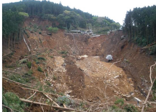
写真1 破壊されたヘッドタンク
