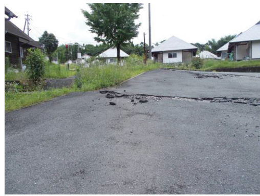
写真8 中原団地の盛土末端の圧縮亀裂
