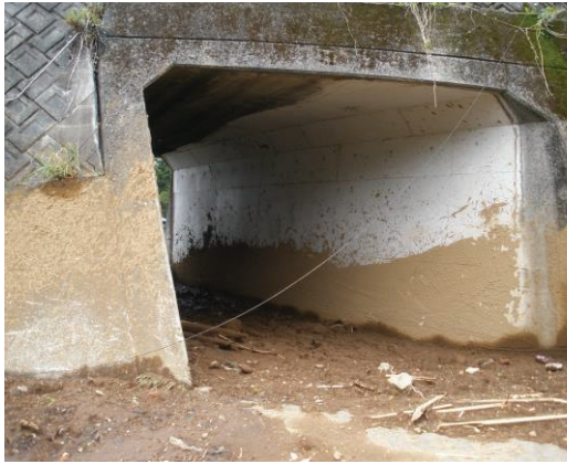
写真3 ボックスカルバートに付着した泥
