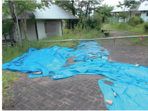
写真7 御船町中原団地の盛土地すべり
