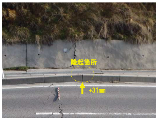
写真2. 移動杭最大垂直変位箇所
