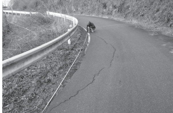
図1. 道路の亀裂の形
