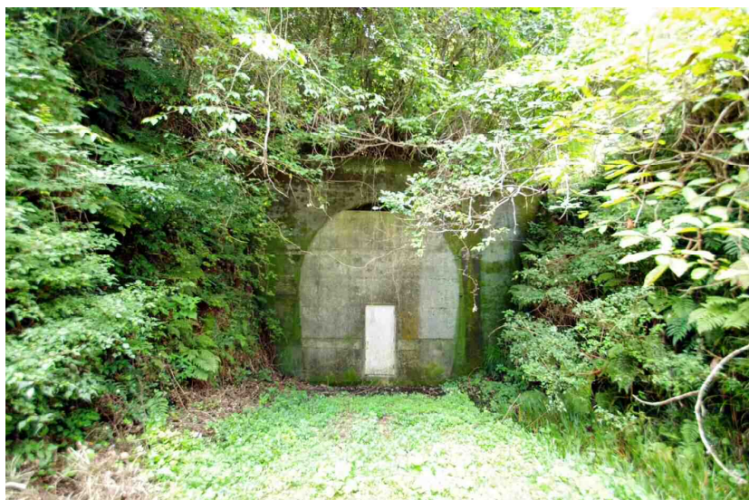
写真-1 閉塞された秋森トンネル起点側坑口（F地点） 坑口下部の隙間より湧水が排出され、外部は一部湿地化している。
