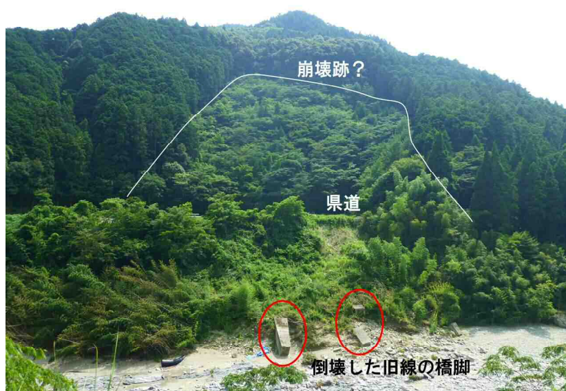
写真-3 吉野川の河原に倒壊・転落した旧線の橋脚 (D 地点) 背後斜面には、崩壊跡とみられる植生が異なる範囲がある。
