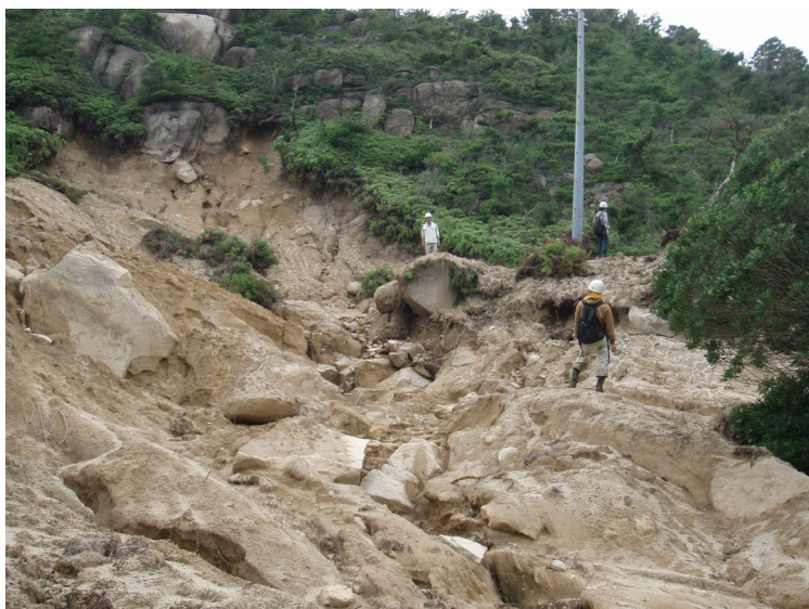
写真－6 神里付近で発生した小沢の土石流 上部に中粒花崗岩の露岩が認められるが、その下位には風化した粗粒花崗岩が分布する。
