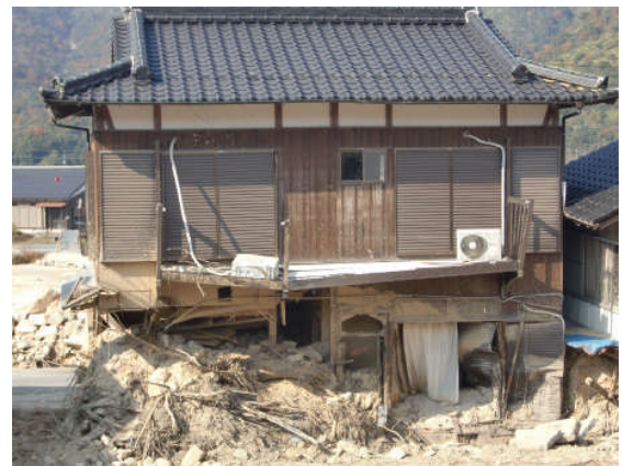
写真－10 土石流で一階が埋まった家
