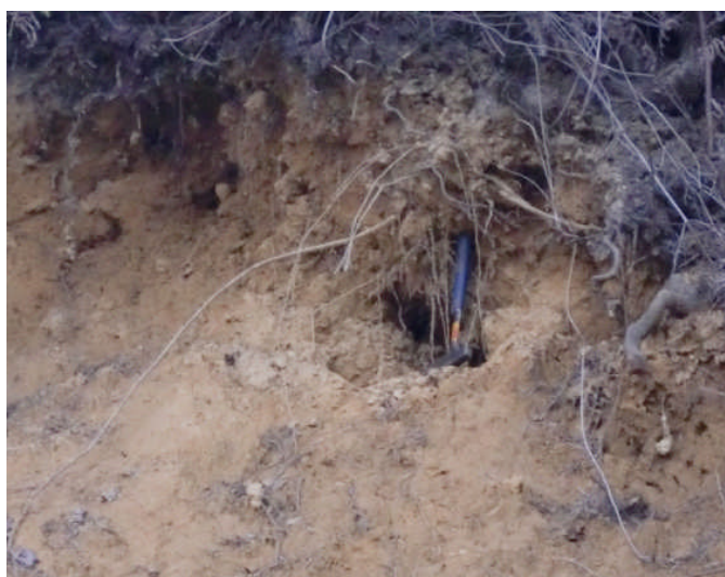
写真－7 崩壊の原因となるパイピングホール
