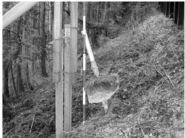
写真-1 固定コンクリートの抜け上がり
