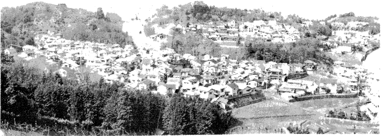
図一七 松山市伊台における住宅の屋根瓦の被害（手前の団地では盛土・切土を問わず被害が多く発生しているが、向う側の高台の団地では盛土・切土ともに被害は少ない）
