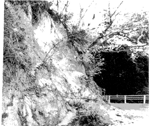
図一4 今治市近見山付近の切土法面の表層崩壊
