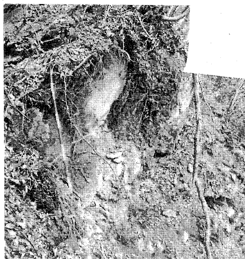
写真-1 落石発生源の状況
