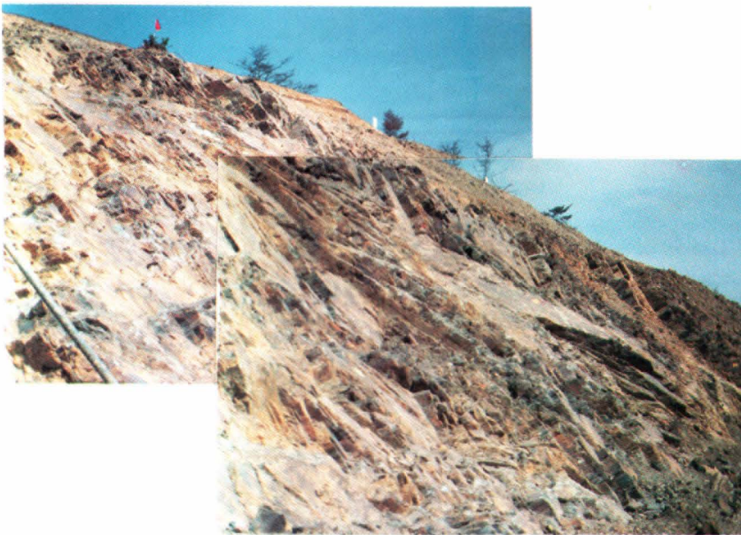
結晶片岩。岩盤分類では C_H 程度であるが，片理がのり面に対して流れ盤となっており，注意が必要である。
