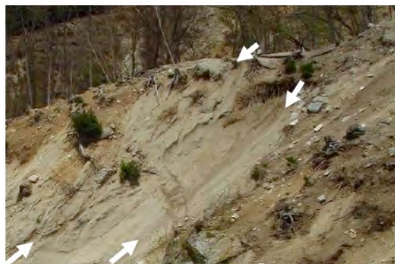
写真-1 区分Ⅱ (頭部) の割れ目。矢印は、砕屑物で充填された割れ目。
