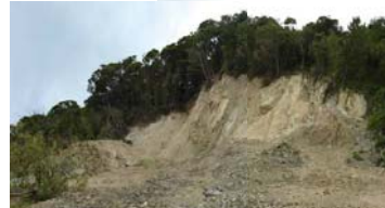
上: 頂部滑落崖 右: 無惨に折れ曲がった電柱
