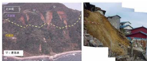
玄界島北側斜面で発生した斜面崩壊と宅地の崩壊
