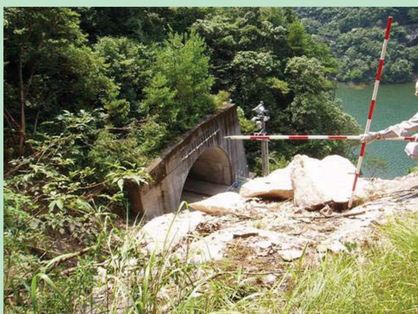
トンネル坑口での落石調査
