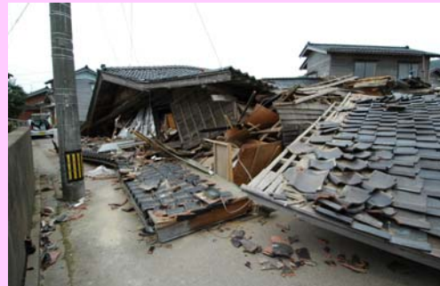
左上写真：輪島市道下地区の倒壊した住家
