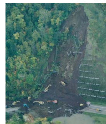
⑧ 平成13年 北陽法面崩壊 (写真:北海道開発局)
