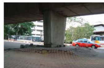
▲ 過剰な地下水汲み上げによる地盤沈下に伴う構造物の浮き上がり(タイ) (Noppadol, P.ほか: バンコクにおける地下水揚水に伴う地盤沈下, 土と基礎Vol.53-2, 2005.)
