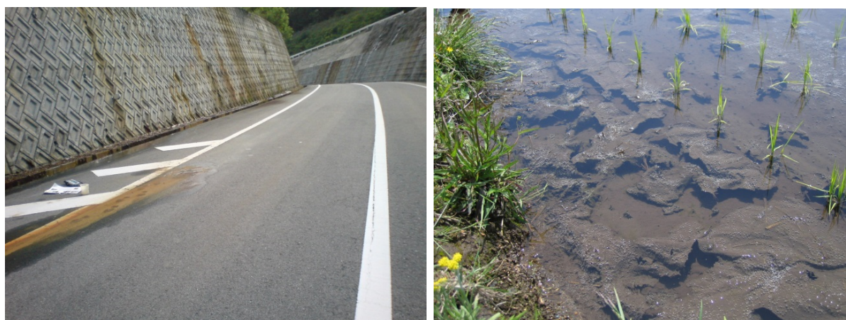
写真-6 酸性水による路盤劣化（左）、水田で増殖した好酸性バクテリアによる表土はく離（右） 好酸性バクテリアの光合成で膜状の土が水面に浮き、錠剤の農薬散布が効かなくなっている
