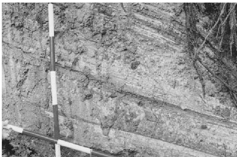
図-2 災害発生時に確認されたすべり面の例 3) (土塊が移動した痕跡である「条線」がすべり面上に認められる。)
