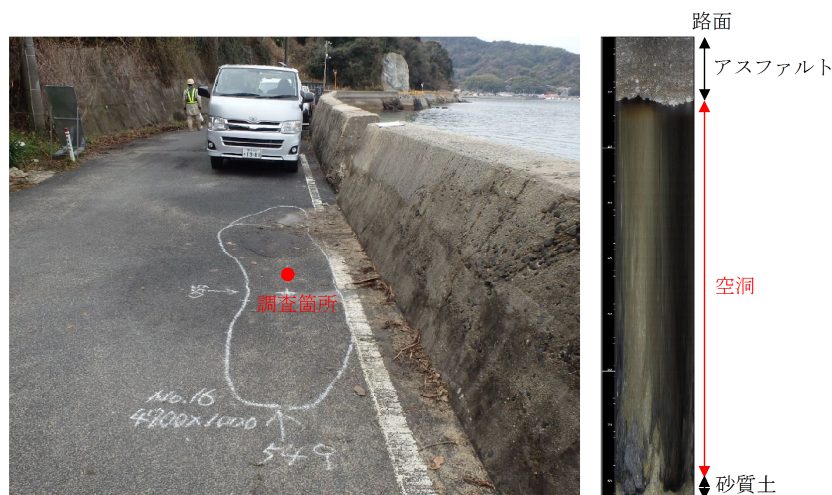
写真-2 地中レーダー探査での異常反射地点とボーリング孔内カメラの映像の例
