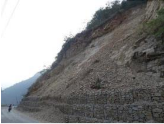
道路斜面崩壊箇所。崩壊面に節理面が露出し、頭部や側方に不安定岩盤が残る。
