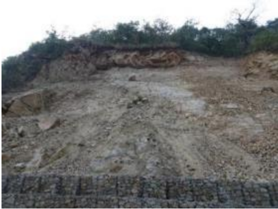
フトンカゴ工により対策されているが、崩壊面には不安定な岩塊が点在して落石の危険。真下で観察するのは非常に危険であるため、急いで移動。
