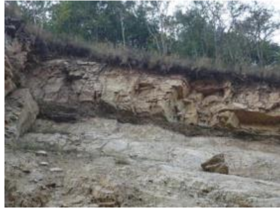
頭部のオーバーハング部。直交する縦亀裂が発達して不安定。暗灰色の層は剪断を強く受けた泥質部とみられ、層面すべりまたはデタッチメント断層の可能性がある。
