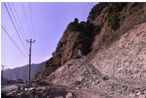
写真-9.5 道路拡幅工事で潰れたブレーカー
