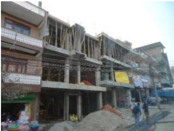
地震で被災したのか、建築中の建物。柱と床はコンクリートで、壁はレンガ積みか。型枠を竹のつかえ棒で支えている。
