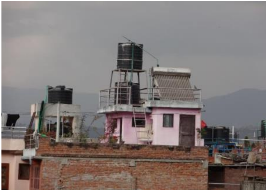
写真-4.8 屋上に設置された給水タンク
