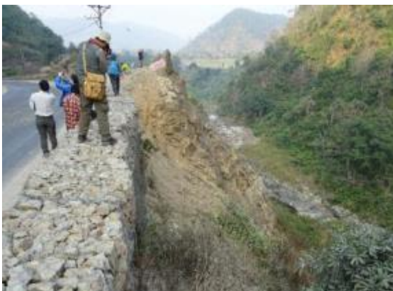
谷側斜面も急崖をなし、斜面に平行な高角度亀裂が発達して座屈変形や微小すべりが生じている。
