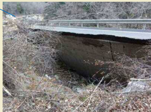
ブロック積壁の背面の吸出しによる盛土の流失
