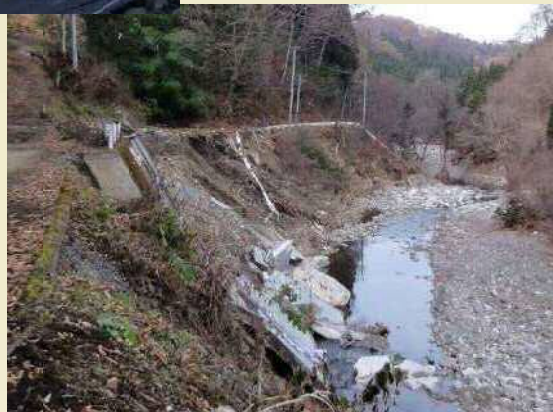
北山下流側の五福谷川沿い (路肩の崩壊)
