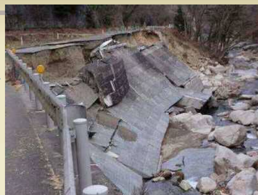
洗堀・背面吸出しによるブロック積壁の倒壊
