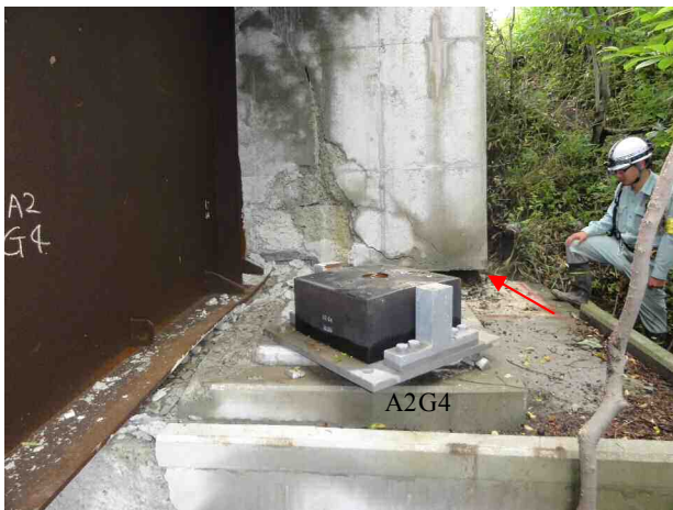
図－９ 南阿蘇側支承部の変位とパラペットの移動
