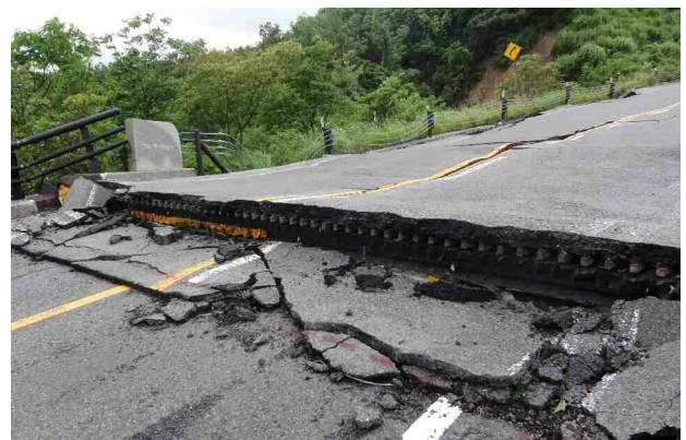
図－7 南阿蘇側桁の伸縮継手の乗り上げ
