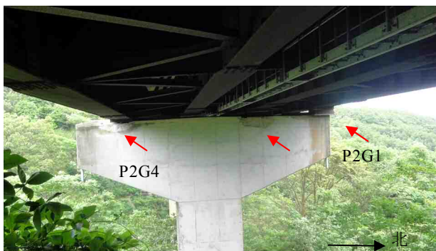
図－１０ 橋桁の北側への相対移動と支承の損傷
