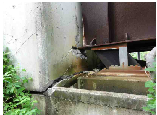
図－１２ 熊本側桁端部の衝突痕とパラペットの損傷
