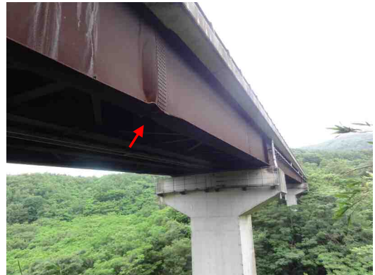
図－１１ P1～P2 橋脚間の桁の座屈変形
