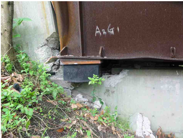
図－８ 南阿蘇側桁端部の衝突と変形
