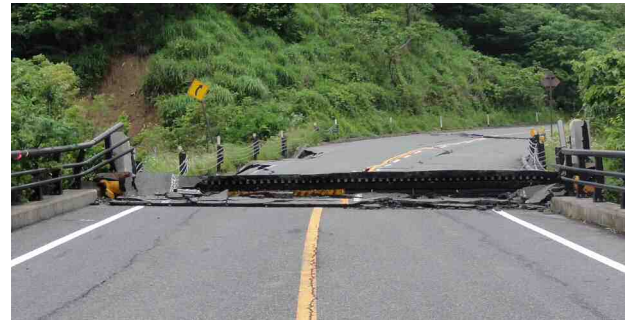
図－5 南阿蘇側橋台部の中央線の右横ずれ
