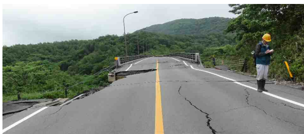
図－1 4 熊本側橋台付近のセンターラインのずれ （熊本側から南阿蘇方向を見る）
