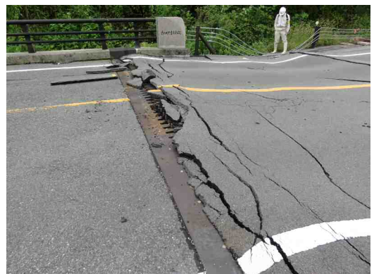
図－１３ 熊本側伸縮継手付近の変状
