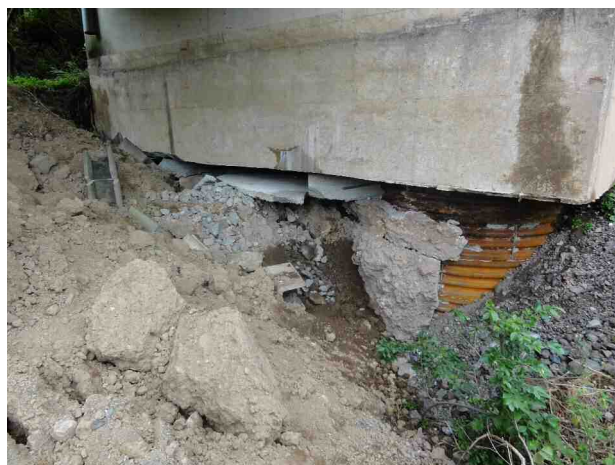
図－1 6 熊本側橋台基礎前面の崩壊
