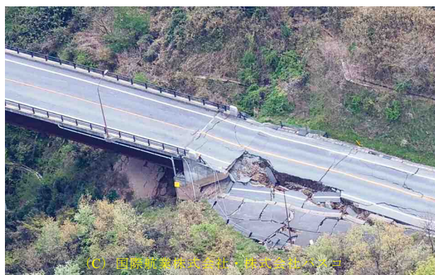
図－1 5 熊本側橋台背面の崩壊 3)
