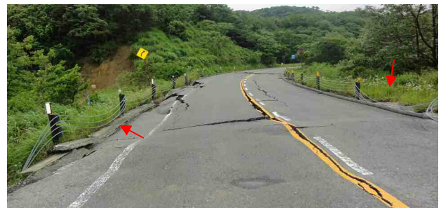
図－6 南阿蘇側橋台背面の変形
